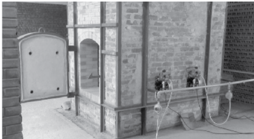
FIGURA 2 - Forno a gás instalado no Centro de Artesanato do Cabo
